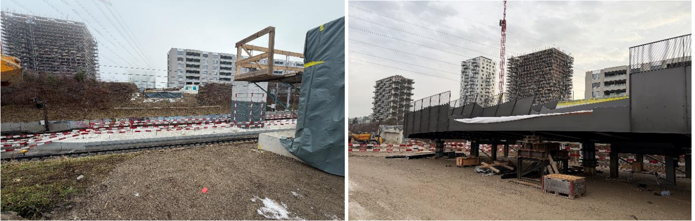
Neue Linienführung der zukünftigen Passerelle inkl. Liftturm sowie zukünftige Brücke in den Vorbereitungsarbeiten
