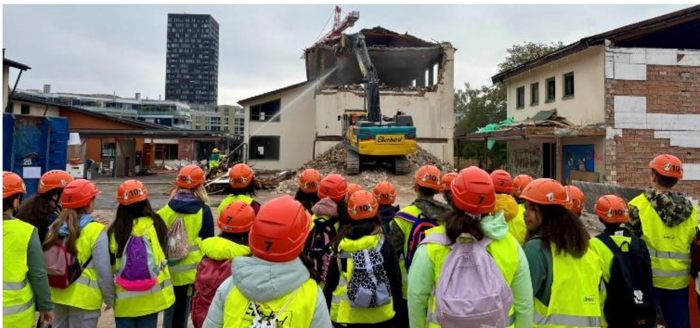
Schülerinnen und Schüler der 5. & 6. Klasse sehen zu, wie der Bagger ihr altes Schulhaus Stück für Stück abträgt.
